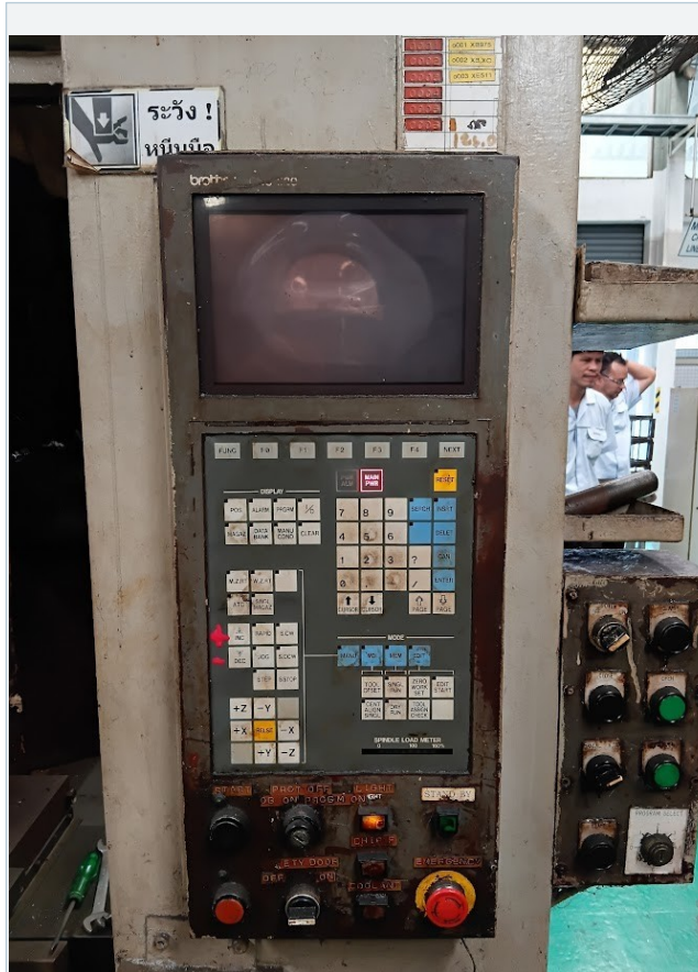
แผงควบคุม
